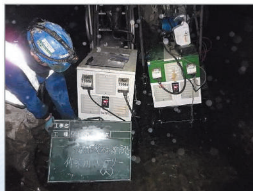
工事現場での 電源確保
