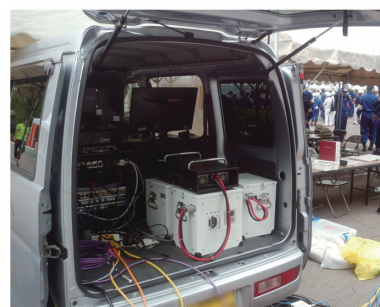
中継放送用機材での電源確保
