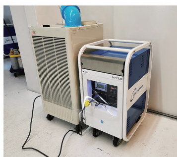
スポットエアコンの電源確保
