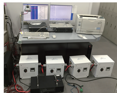
法定停電での電源確保
